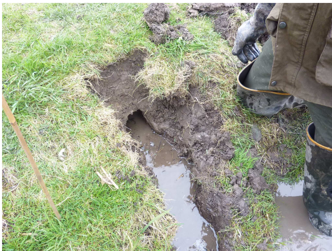
Graafwerk van de muskusrat kan diep een kering ingaan. Een kering die het hoger gelegen oppervlaktewater uit de polder moet houden wordt dan ernstig verzwakt.
